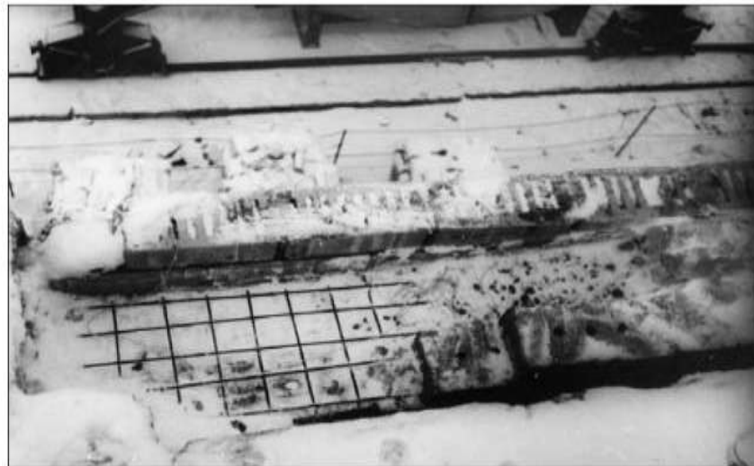
Рис. 2.2.2. Попадание снега и мусора в полость для утеплителя. 1991 г.
