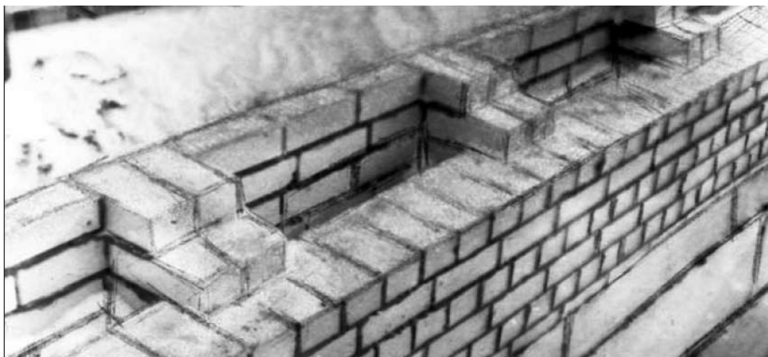
Рис.1.2.13. Наружная стена из колодцевой кладки семиэтажного жилого дома в Таллине. Фото 1986 г.
