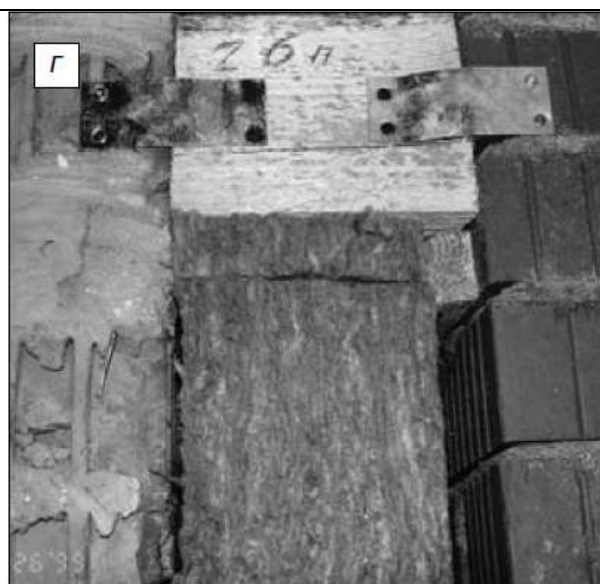
Рис.1.2.32. Строительство здания англо-американской школы с наружными стенами из кладки с гибкими связями, Москва, 1999 г. а- фрагмент фасада; б- простенок с внутренним слоем из кирпичной кладки усиленной стальными уголками; в- простенок с внутренним слоем из монолитного железобетона ; г- стена с внутренним слоем из кирпичной кладки.
