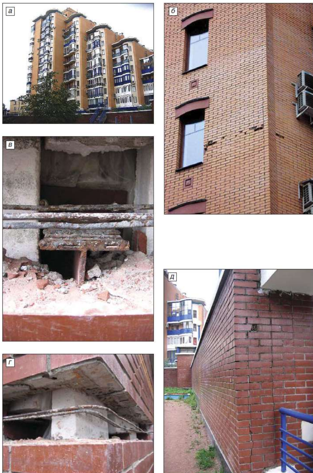
Рис. 2.3.10. Жилой дом на ул. Старослободской в Москве, 2006г. а- общий вид; б- вертикальные трещины на углу стен и разрушение кладки в уровне перекрытия ; в- стальные кронштейны для опирания на них кладки наружного слоя; г- армирование наружного слоя стены отдельными стержнями; д- температурные трещины в лицевом слое наружной стены одноэтажного въезда в гараж
