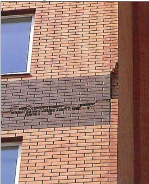
Рис. 2.3.12. Раздробление кирпичей в уровне перекрытия вследствие отсутствия горизонтальных деформационных швов образования вертикальной трещины вследствие отсутствия вертикальных деформационных швов, Москва. 2002 г.
