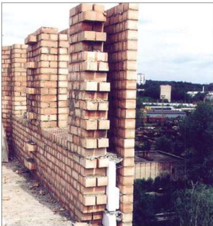
Рис. 2.5.5. Отсутствие гибких связей на всю высоту простенка. Г. Красногорск.1999 г.
