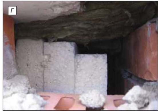
Рис.2.2.1г. Неплотное прилегание плит утеплителя к низу плиты перекрытия (дом на улице Петрозаводской). 2007 г.
