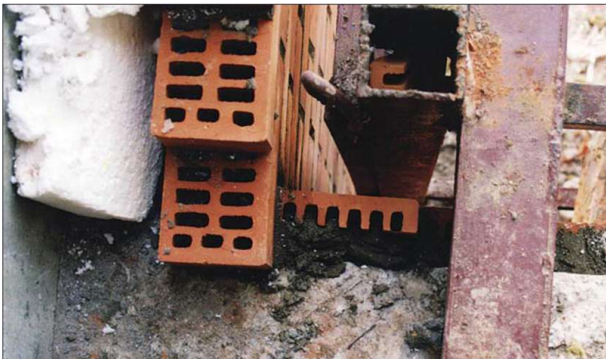
Рис. 2.3.1. Смещение несущего наружного слоя кладки в сторону улицы, исключаяющее устройство горизонтального деформационного в г. г.Одинцово.1999 г.
