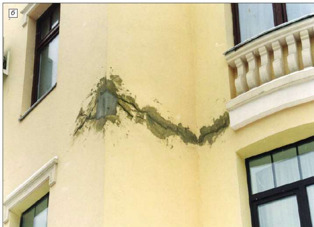
Рис. 2.5.1а,б . Жилой дом на ул. Плющиха в Москве. 2003 г. а- общий вид здания; б- горизонтальные трещины в уровне перекрытия.
