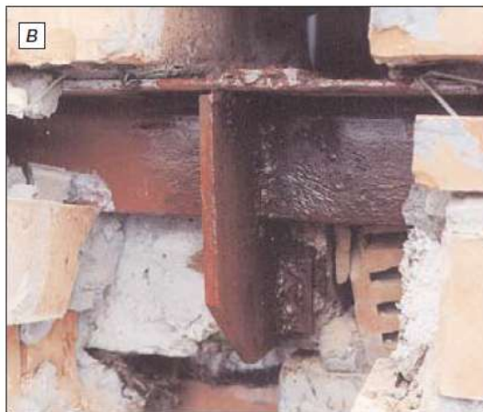
Рис. 2.3.3. Жилой дом на ул. Молодогвардейская в Москве, 1999 г. а – свес наружного слоя кладки со стального уголка на 15 см вместо 4-х по проекту; б – некачественное крепление стального опорного уголка; в – подведение под опорный уголок стальных кронштейнов в ходе ремонта
