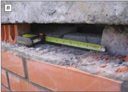
Рис.2.2.1в. Продуваемый зазор между низом перекрытия и верхом кладки внутреннего слоя из ячеисто-бетонных камней (дом на улице Петрозаводской). 2007 г.
