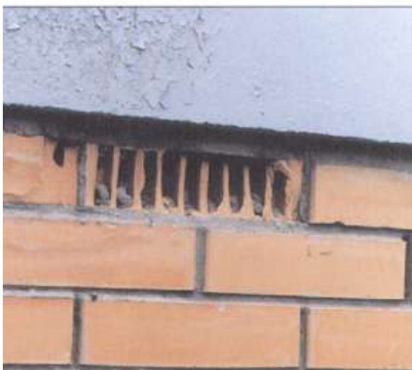
Рис.2.3.8. Раздробление кирпичей под плитой перекрытия вследствие отсутствия горизонтального деформационного шва. Москва, 2000 г.
