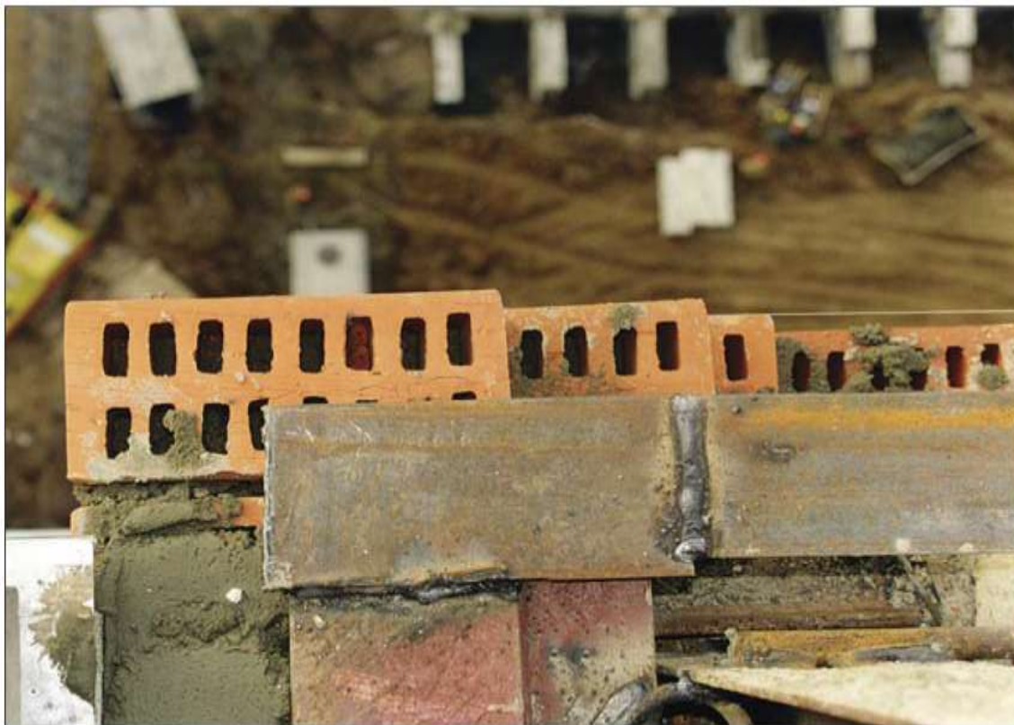
Рис. 2.3.2. Свес наружного слоя кладки на 7 см в сторону улицы. Г. Москва, ул. Молодогвардейская. 1999 г.
