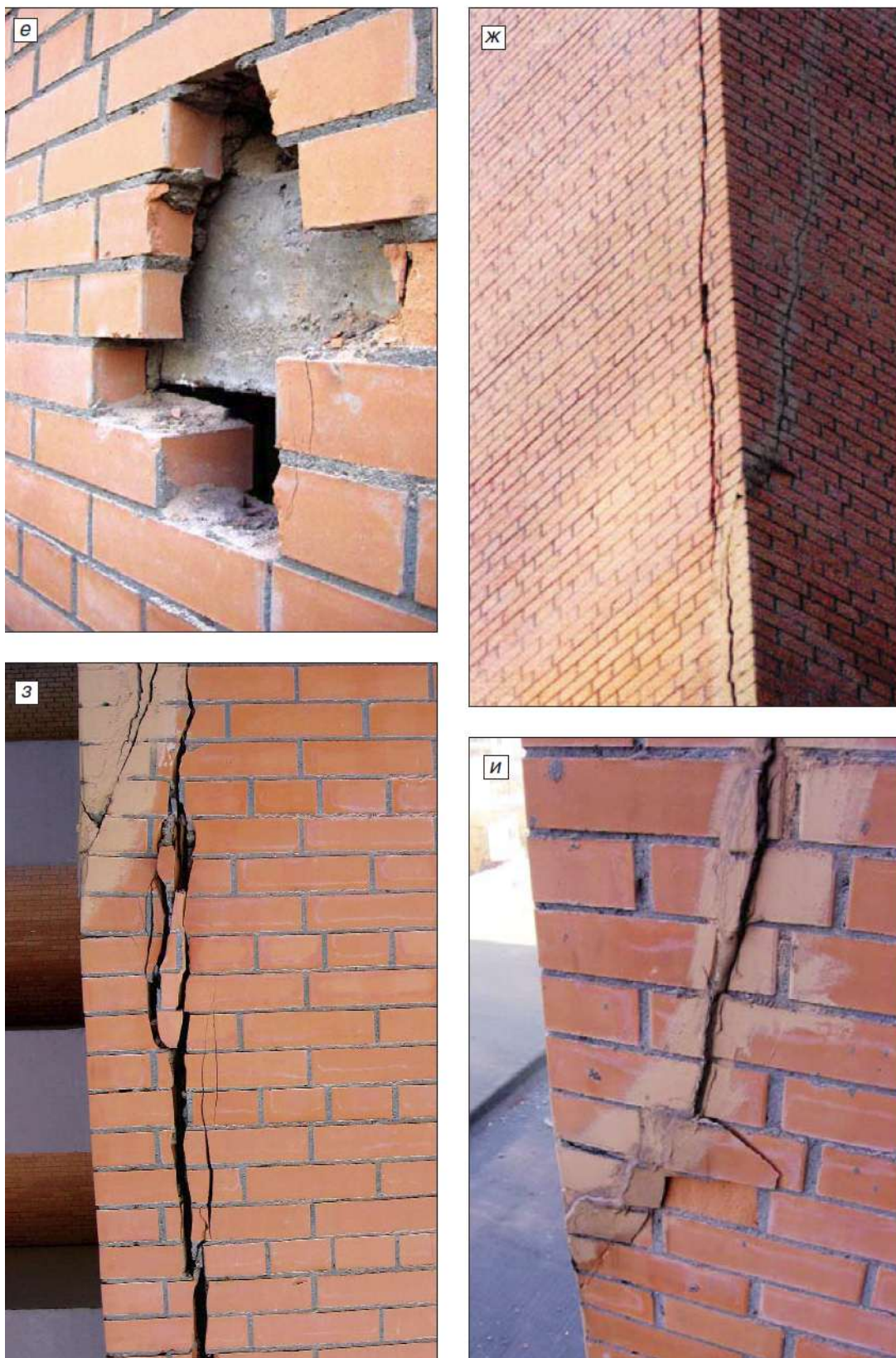
Рис.2.3.7 е-и. Жилой дом на ул. Магнитогорской в Москве: е- отсутствие перевязки кладки в уровне верха плиты перекрытия; ж- фрагмент стены в осях 4/Г. Вертикальные трещины в уровне 4-6- го этажей; з- вертикальная трещина на углу стены между 3-м и 4-м этажами.
